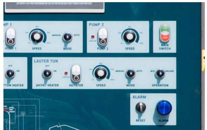
Die gesamte Steuerung und Überwachung aller Vorgänge an einem Ort mit fortgeschrittenem und praktischem Bedienfeld.
